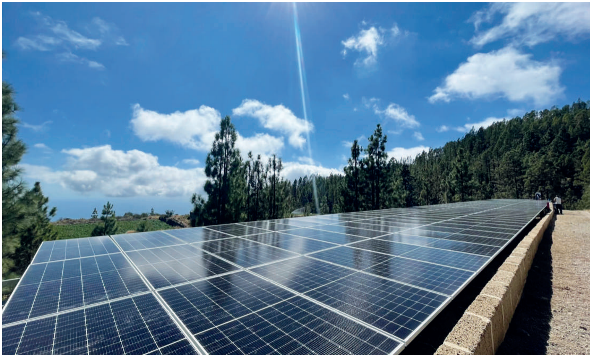
Marquesina de 100kWp del hotel Spa Villalba en Vilaflor.
